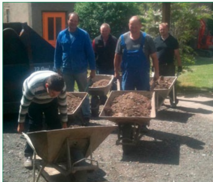
Ehrenamtliche Helfer bei der Sanierung des Gemeindehauses. Ohne diese Unterstützung hätte das Vorhaben nicht begonnen werden können.
